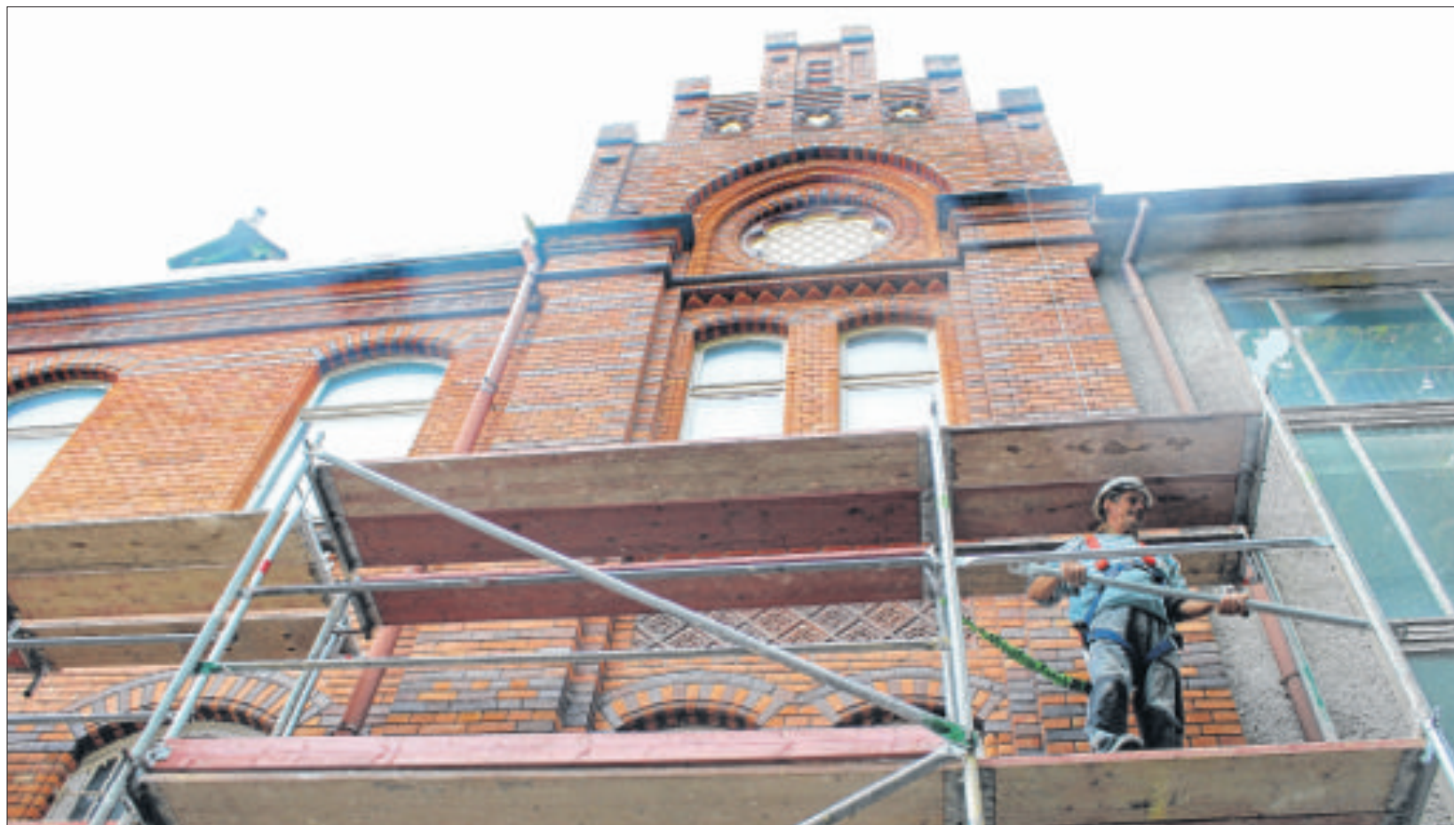
Gestern wurde damit begonnen, ein Gerüst an der Fassade des historischen Postgebäudes aufzustellen. Bekanntlich soll der repräsentative Backsteinbau in den kommenden Monaten zum Hostel umgebaut werden. Fotos: Tom Schröter
