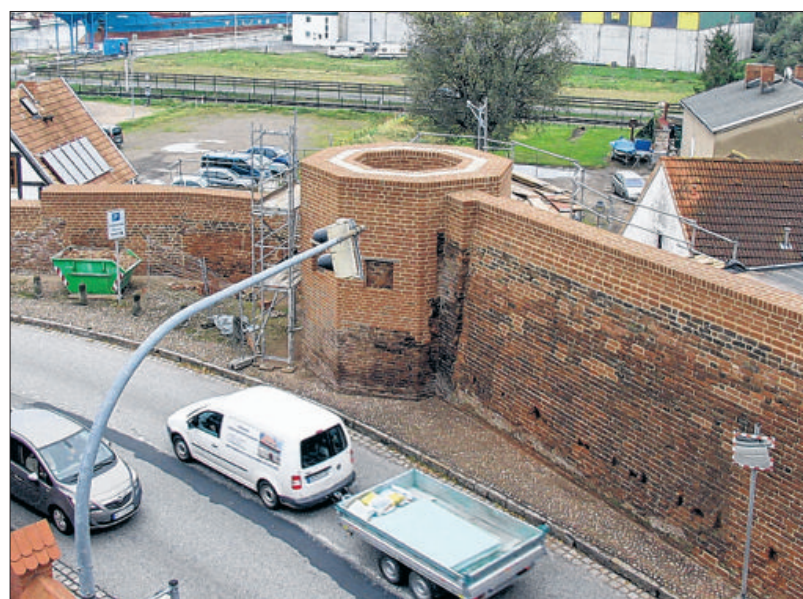
Bei der im vorigen Jahr vorgenommenen Sanierung der Stadtmauer wurden offenbar minderwertige Steine verwendet. Foto: Tom Schröter
